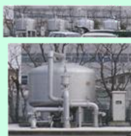
急速ろ過設備 (2万t/d)
